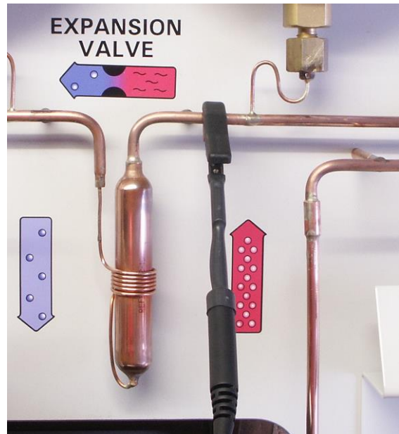
Fig. 1: Temperaturmessung vor dem Expansionsventil der Wärmepumpe
